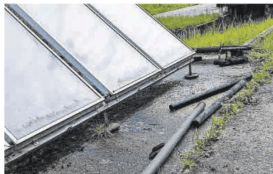
Restos de la instalación de paneles solares en la piscina de Sotrondio
